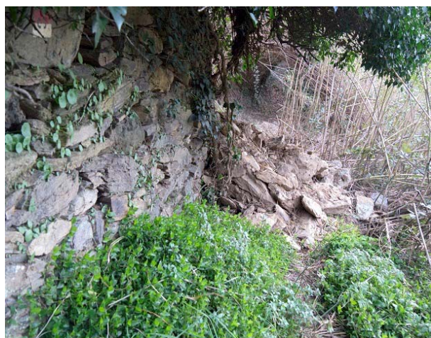
Figure 4: Un muretto a secco franato
