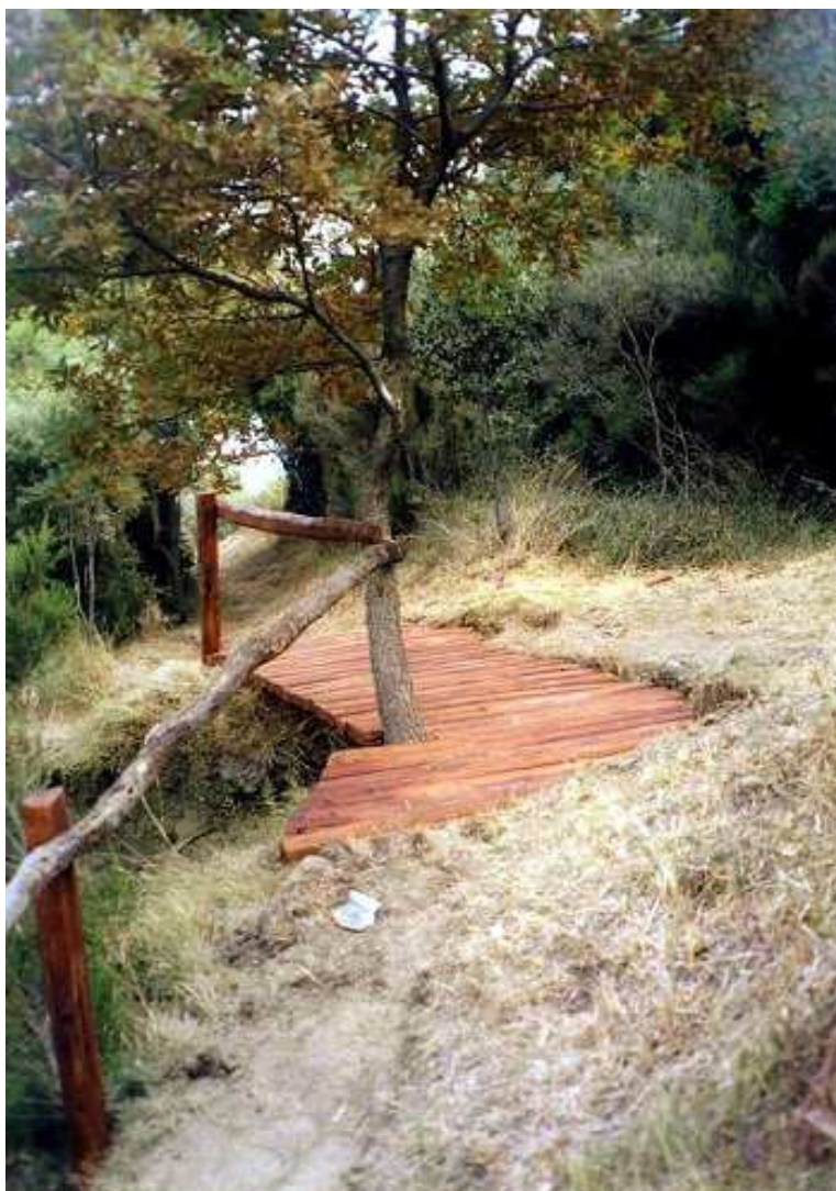
Uno degli interventi di manutenzione in località Pruxia (2006): realizzazione di una passerella sopra una frana
